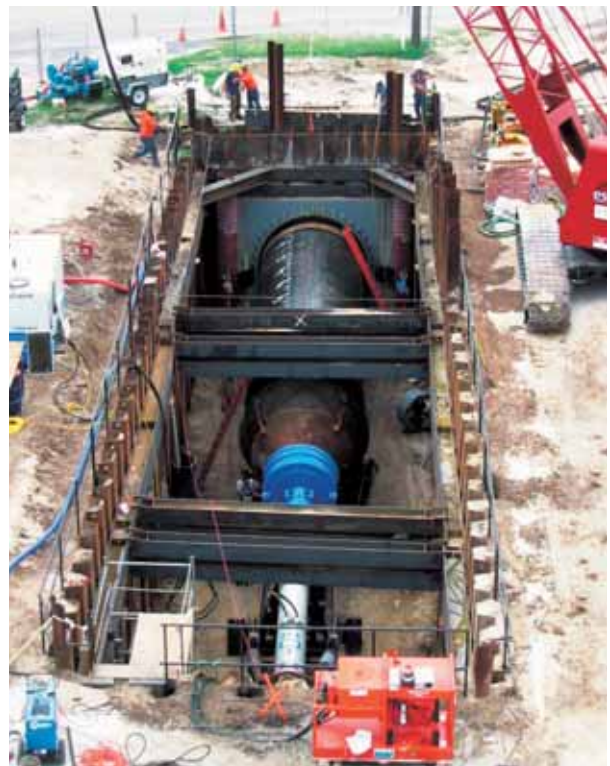
Het aanleggen van een tunnel in Florida in de VS middels het horizontaal heien met een IHC hydrohamer.
