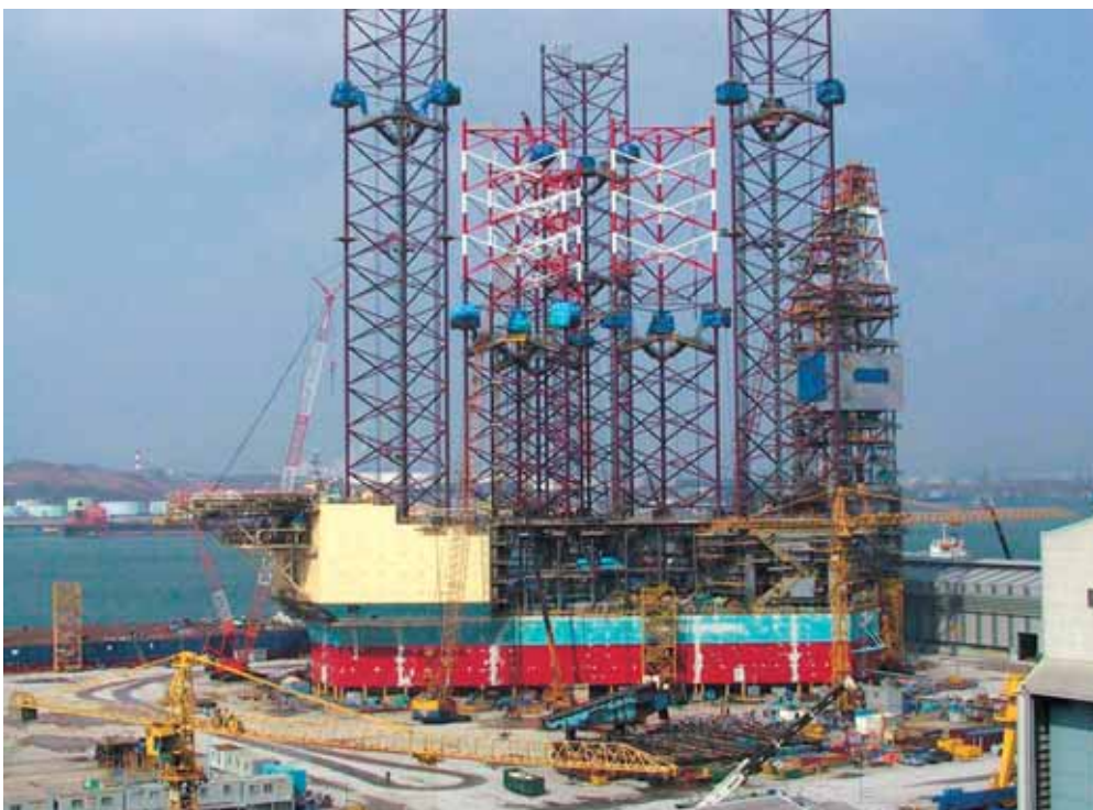
Het MSC CJ70-150 MC zelfheffend booreiland in aanbouw op de werf van Hyundai Heavy Industries in Korea.
