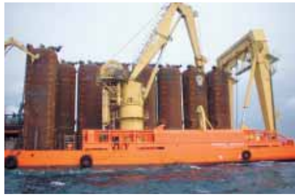
Vorbereidende installatiewerkzaamheden voor het verankeren van de Serpentina FPSO door het werkschip Normand Progress van SBM, met negen zuigankers gereed om in 900 meter diep water te worden uitgezet.
