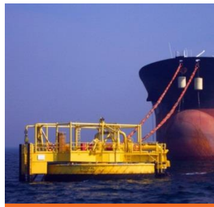
Terminals & Aftersales (Imodco)
